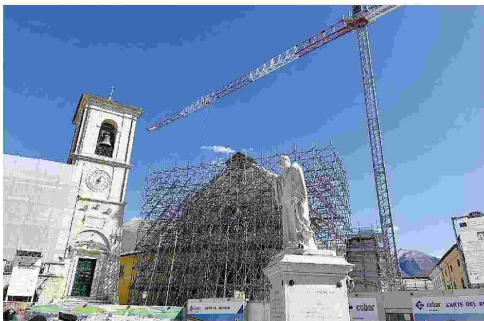
La Basilica di San Benedetto, a Norcia, distrutta dal sisma, è ingabbiata dall'impalcatura
