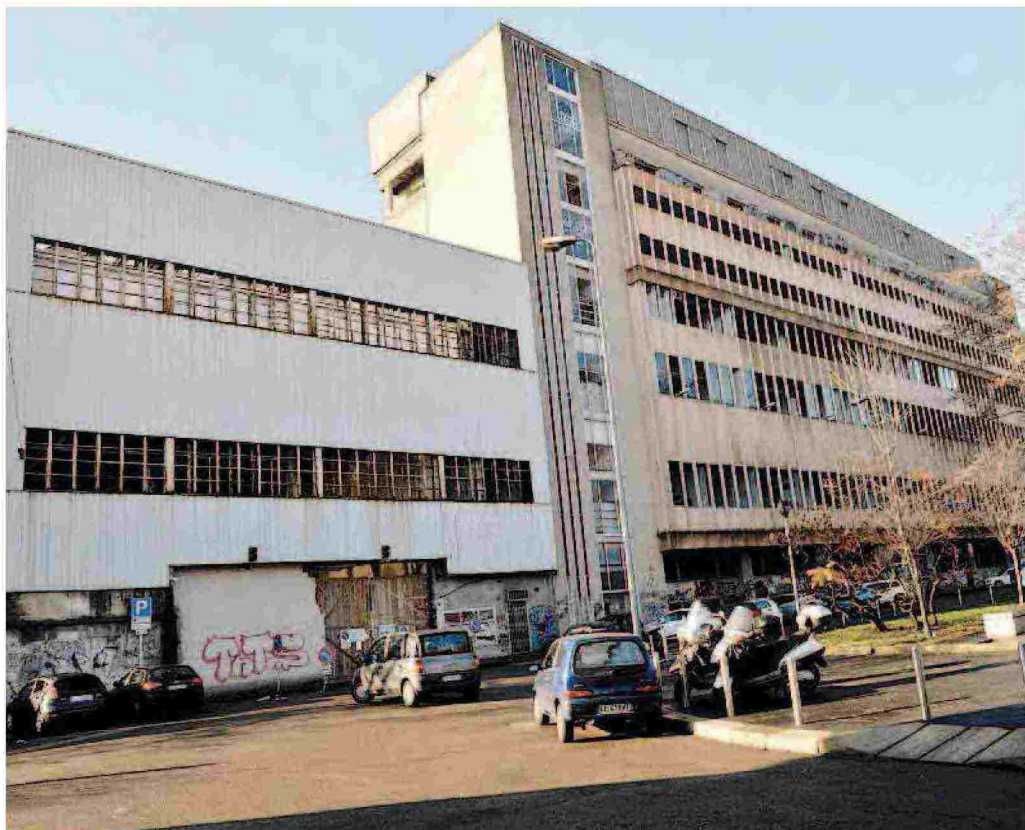
L'ex centro delle poste in piazzale Lugano in attesa di un progetto di risanamento
