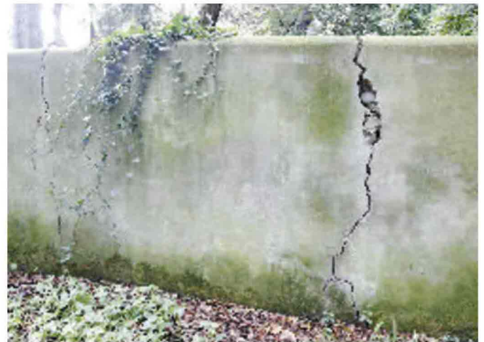
Muro di cinta È pericolante, le crepe sono enormi
