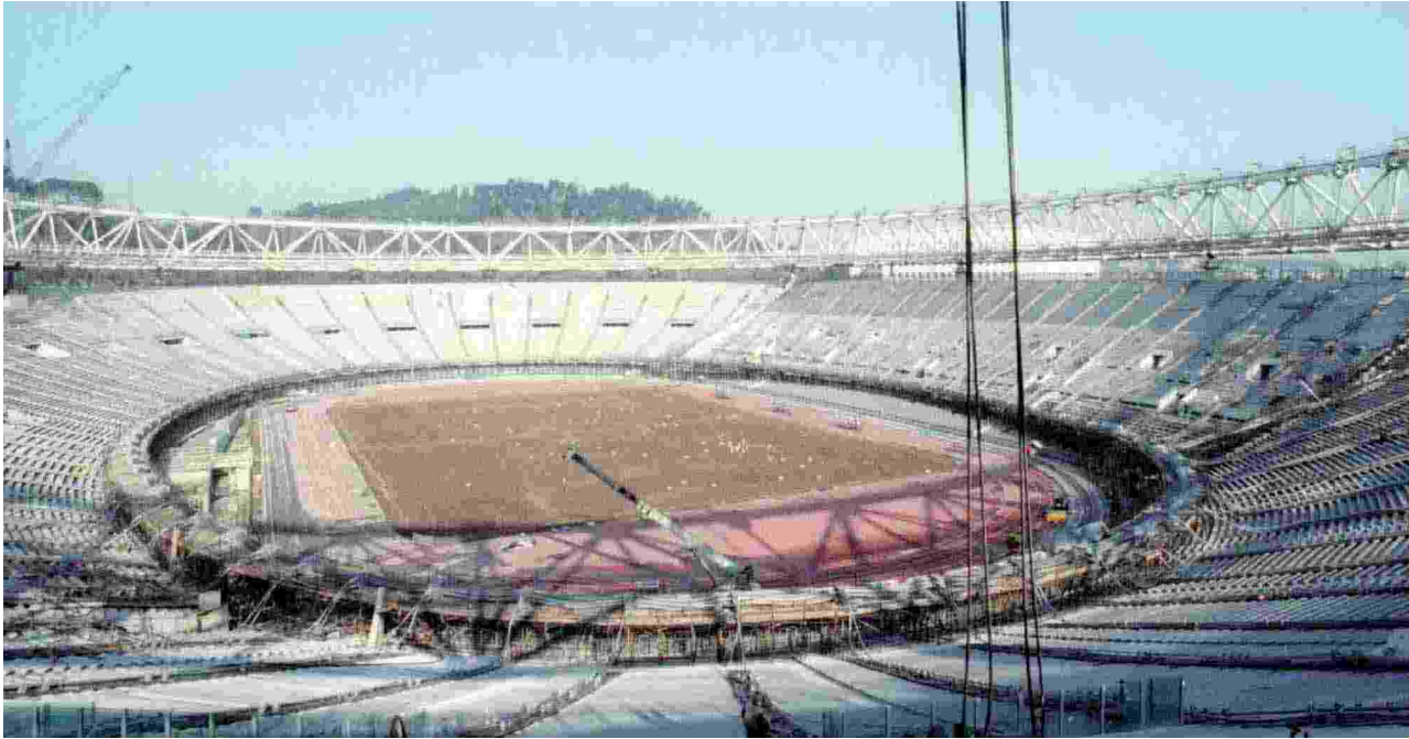
I lavori di ampliamento dello Stadio Olimpico in occasione di Italia 90 / Ansa
