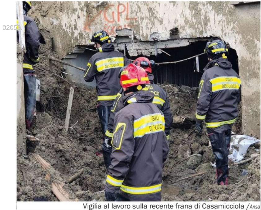
Vigilia al lavoro sulla recente frana di Casamicciola /Ansa
