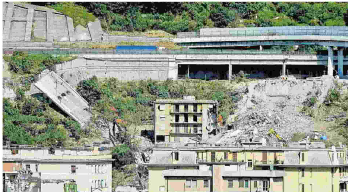
▲ La demolizione Lo scorso 28 giugno, a Genova, è iniziata la demolizione del ponte Morandi
