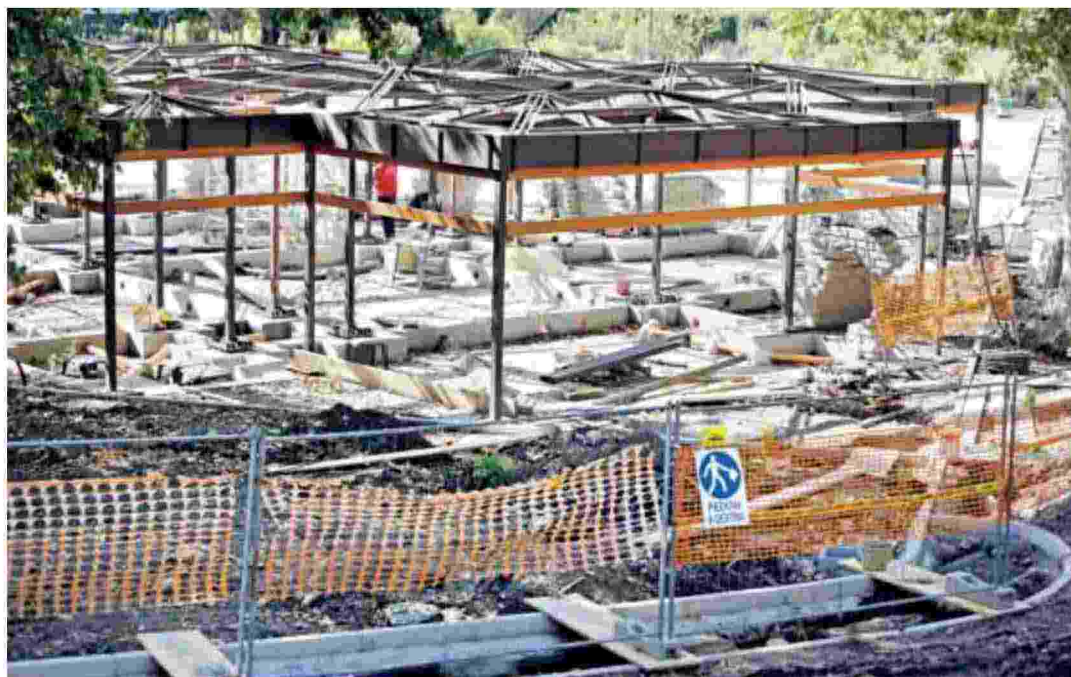
▲ Il progetto del fast food Il cantiere a pochi metri dalle Terme di Caracalla a Roma
