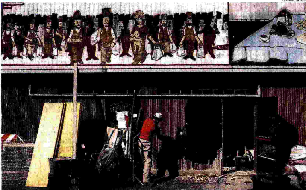
ABBATTERE I MURI | Il progetto G124 di Renzo Piano al Quartiere Giambellino di Milano: la demolizione del muro sud del mercato con l'apertura di un nuovo ingresso e la realizzazione di una pedana esterna per attività sociali
