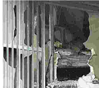
Le sbarre alle finestre del capannone distrutto dal rogo
