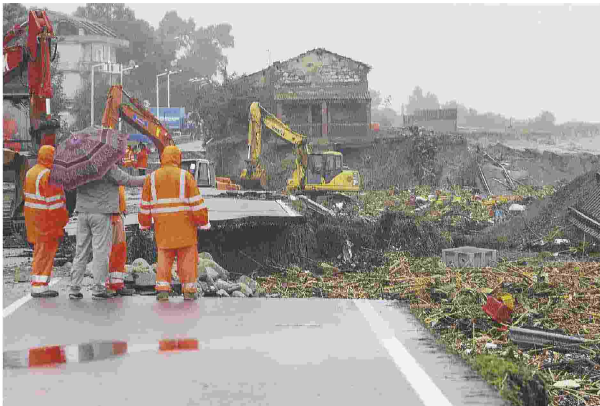
..... Sud, 2015 Ferrovia e strada interrotta a Brancaleone (R. Calabria) per maltempo. Sotto, l'ex capo di Italia Sicura Erasmo D'Angelis
