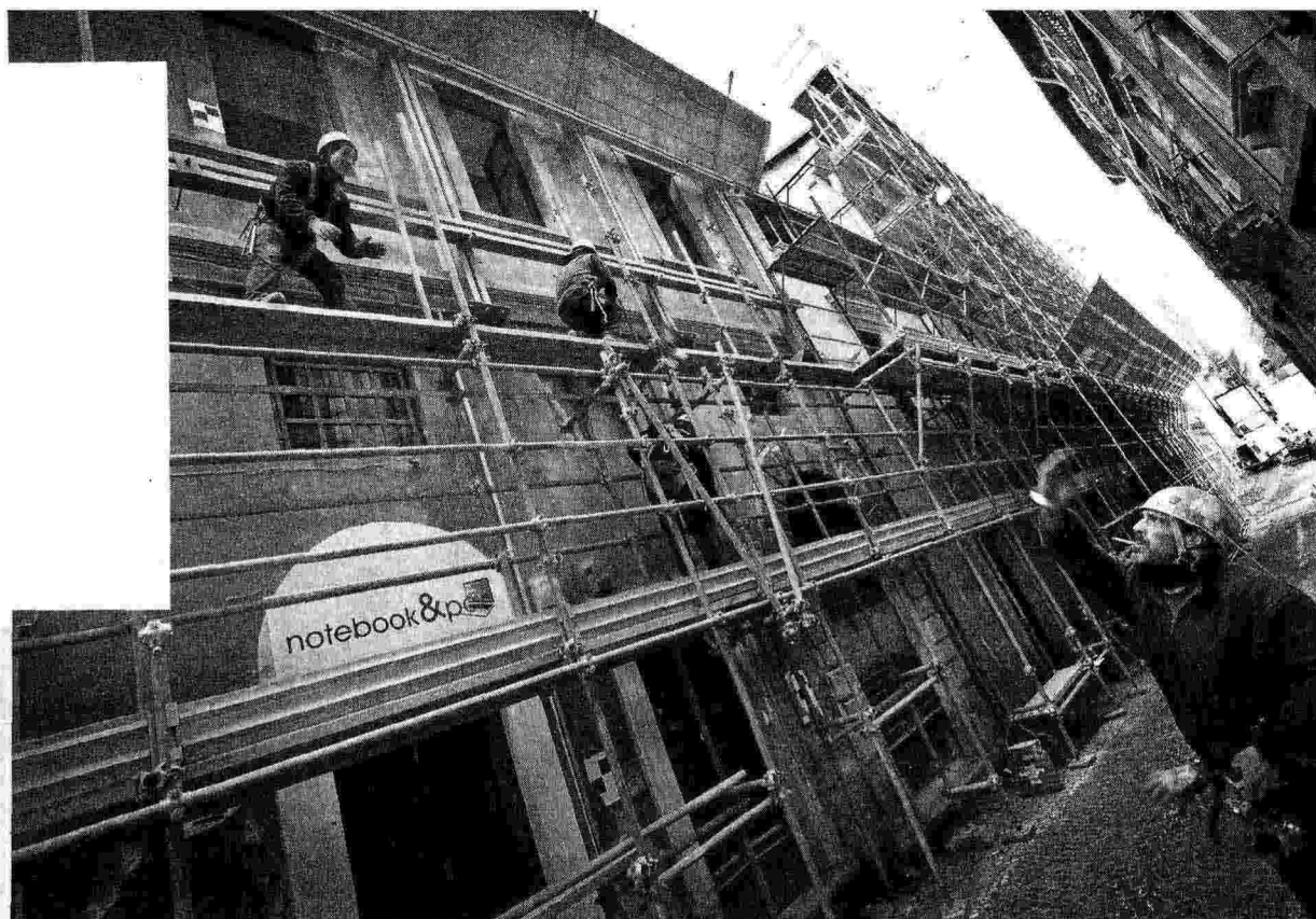
LAVORI IN CORSO ALL'AQUILA FOTO MANUEL ROMANO-LAPRESSE. IN ALTO, IL RICORDO DELLE VITTIME PER IL SESTO ANNIVERSARIO DEL TERREMOTO
