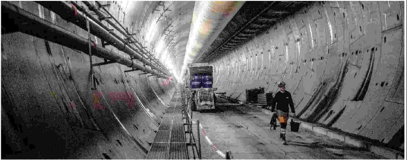
Il cantiere per la costruzione del tunnel geognostico di Saint-Martin-La-Porte, in Savoia, nel tratto francese della Tav
