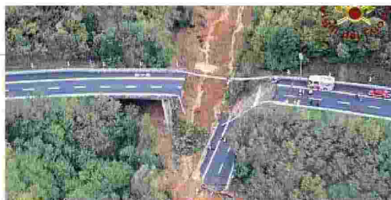
Sulla A6 Un tratto di viadotto Madonna del Monte sulla Torino-Savona è stato spazzato via da una frana, domenica scorsa
